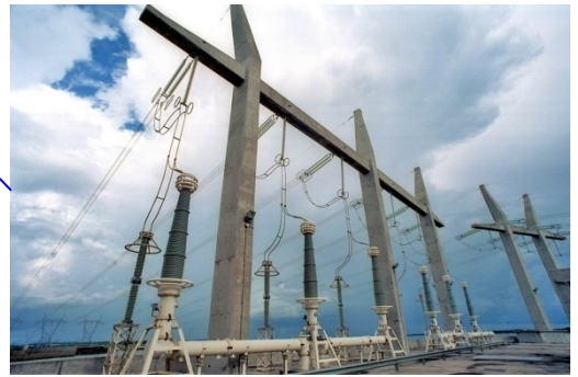
Interconexión eléctrica Yaciretá
